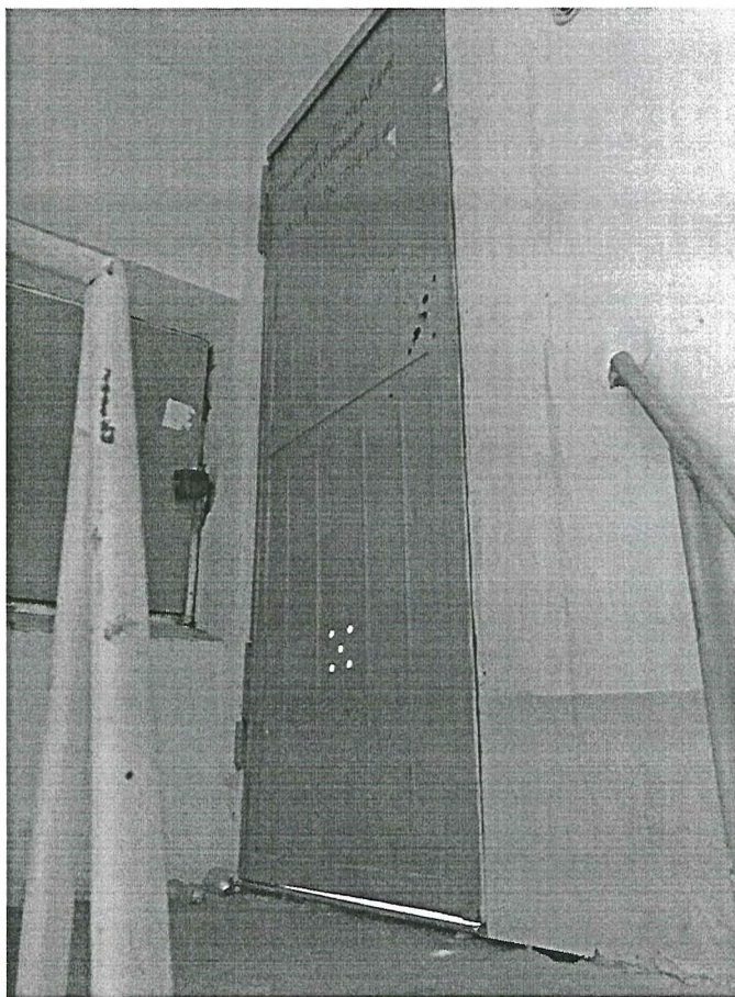
Рисунок 4 – Вход в машинное помещение
